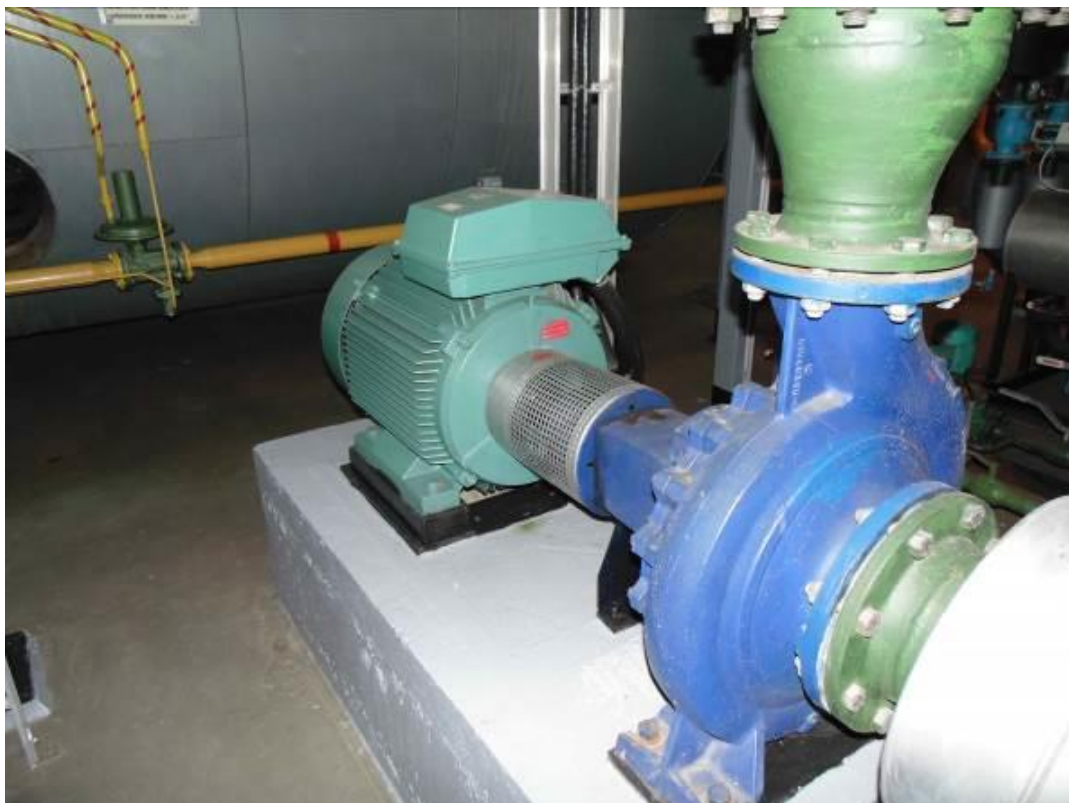
Рисунок 2.1.2.11 - Насосное оборудование котельной №62
