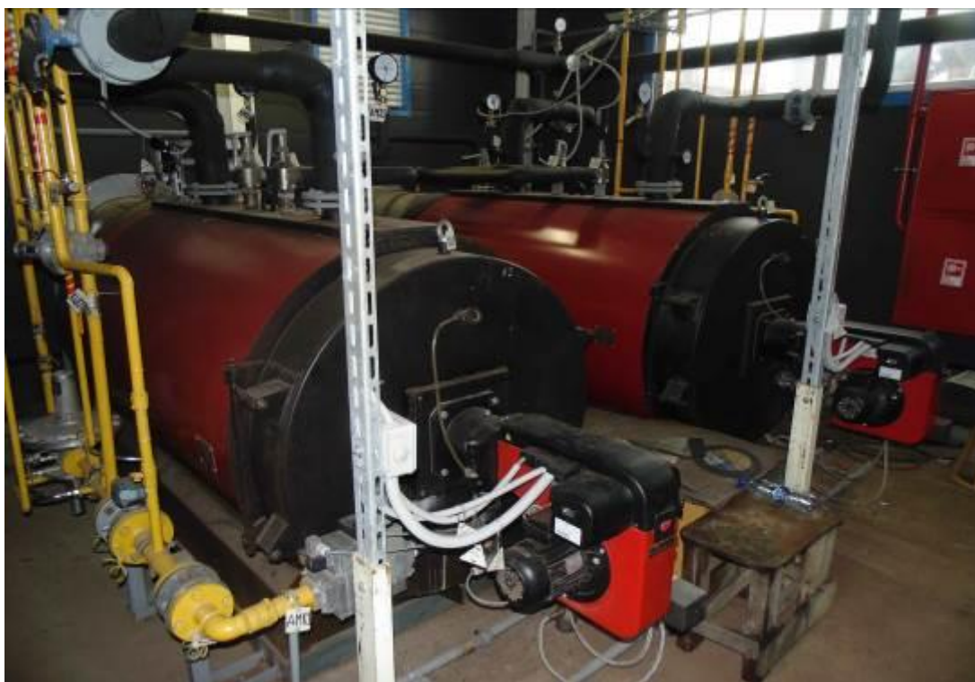
Рисунок 2.1.2.5 - Котловое оборудование котельной 1 МВт
