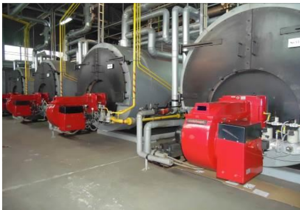
Рисунок 2.1.2.10 - Котловое оборудование котельной №62
