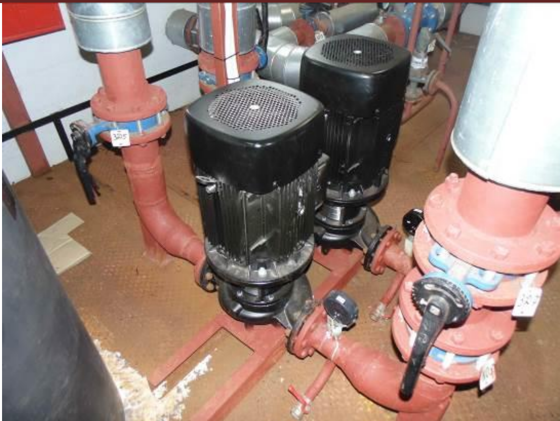
Рисунок 2.1.2.3 - Насосное оборудование котельной 2,7 МВт
