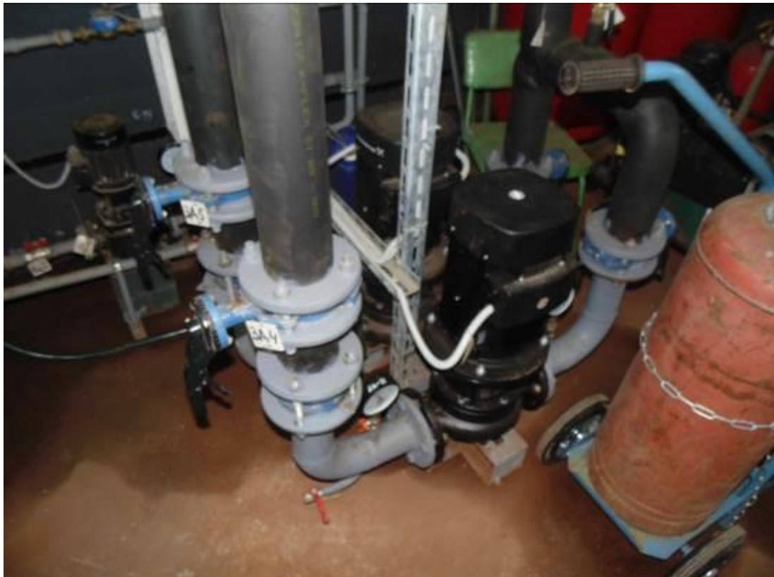
Рисунок 2.1.2.6 - Насосное оборудование котельной 1,0 МВт
