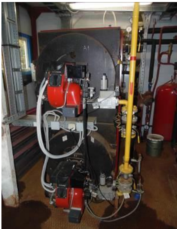
Рисунок 2.1.2.8 - Котловое оборудование котельной 0,5 МВт
