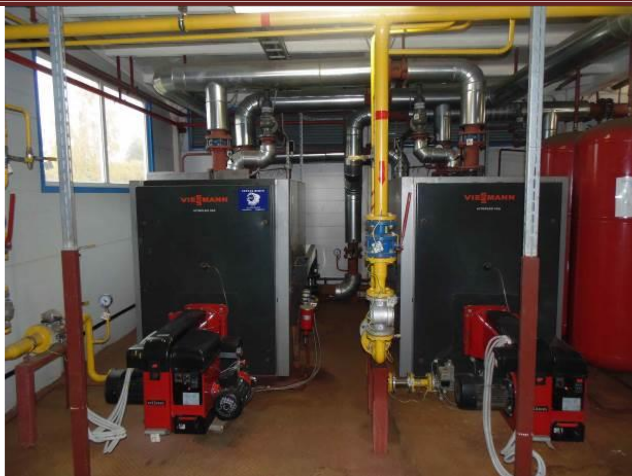
Рисунок 2.1.2.2 - Котловое оборудование котельной 2,7 МВт
